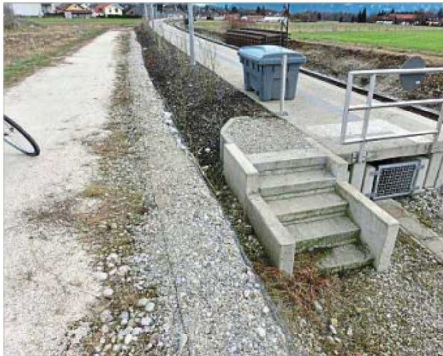
Diese Treppe zum Bahnsteig in Hofham ist nur über einen Graben zu erreichen, monierte Andreas Egert. Das stelle eine Gefahr speziell für ältere Leute dar. – Foto: Pro Freilassing
